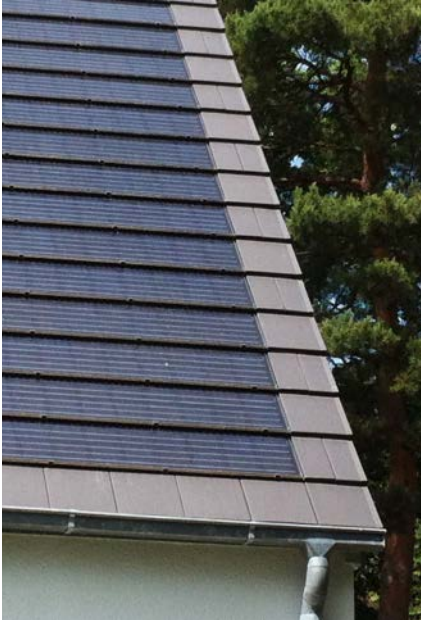
POSITIVBEISPIEL: IN DIE DECKUNG - INTEGRIERTE PHOTOVOLTAIKMODULE
